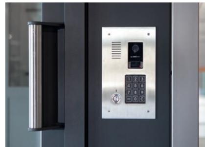
Technische Säule mit Gegensprechanlage
