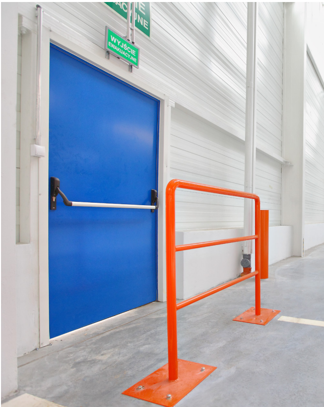
Brandschutztür aus Stahl mit Panikhebel
